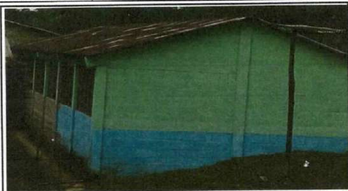
Foto 1: La cubierta de lámina de la escuela se encuentra deteriorada y con goteras.
