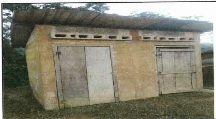
Foto 4: Las puertas de los sanitarios son de madera, estando a la intemperie se ha deteriorado.
