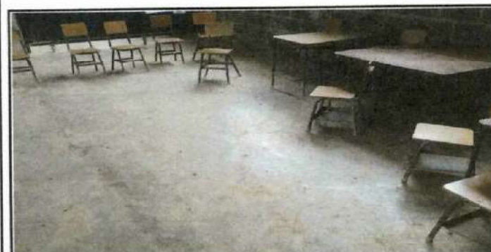
Foto 5: El suelo de la escuela es de torta de concreto, se ha deteriorado.
